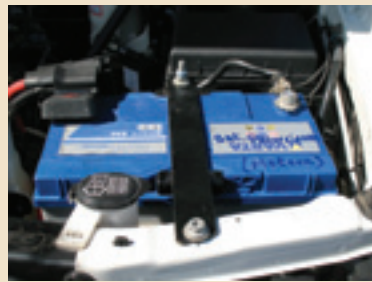
La batterie principale délivre une puissance de 95 ampères.
