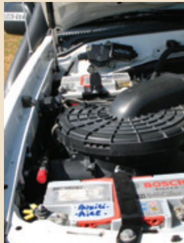
Sur la droite, les deux batteries auxiliaires gèrent les périphériques.
